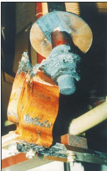
5 Schaden an einem 110/10 kV Transformators durch Überhitzung
